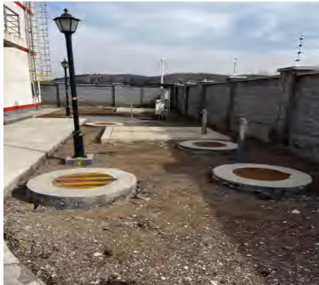
生活污水处理设施
