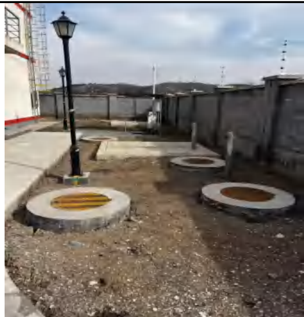
生活污水处理设施
